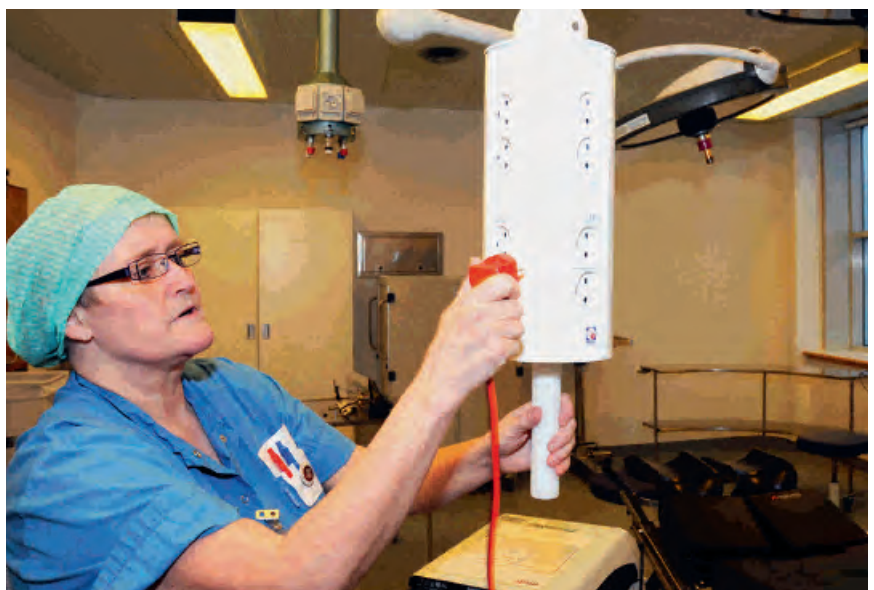
Arbejdsmiljørepræsentant Susanne Johansen har samarbejdet med teknisk afdeling og en leverandør om at få styr på ledningsrodet på operationsafdelingen.
